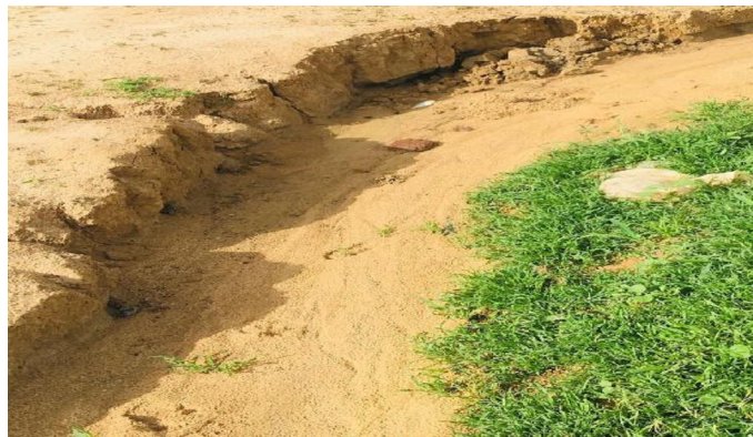
Photo n°1 : Affouillement par érosion hydrique
