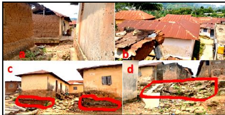
Planche n°4 : Murs pisés vétustes (a), toiture usée (b) et fondation déchaussée (c, d)
