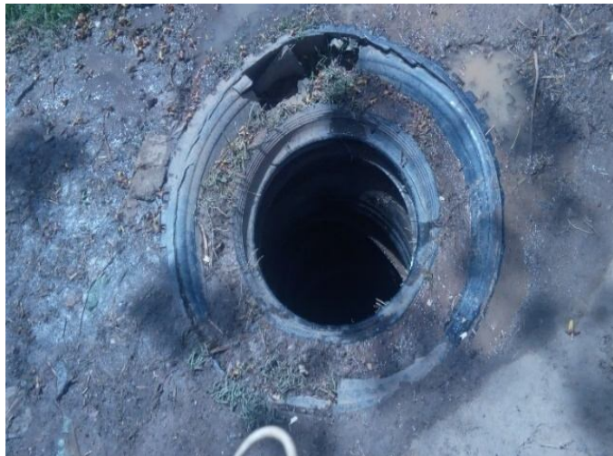
Photo n°1: Puits mal protégé et mal entretenu dans 1 ménage au secteur 17
